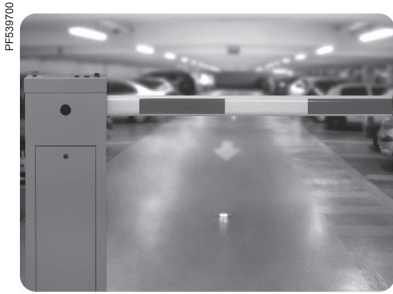
ATV12控制出入口栏杆
